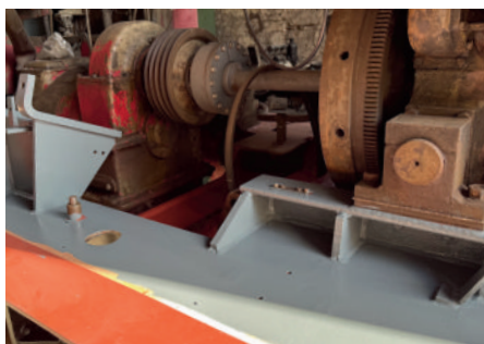
▲ Ein Teil des Motorraums ist lackiert. Bild: Martin Kapp.
